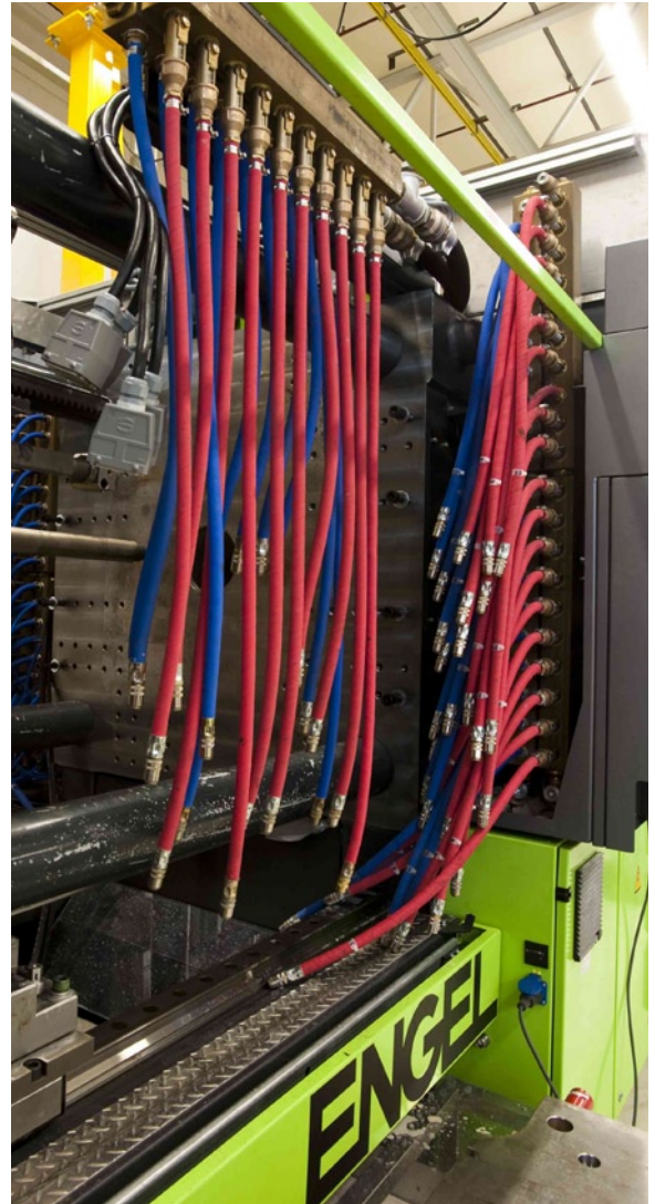
Een Speed 500 van Engel spuitgiet onderdelen voor tapvaten van een bekend merk. De matrix heeft honderd koelringen, waarvan er niet één is doorgelust.
